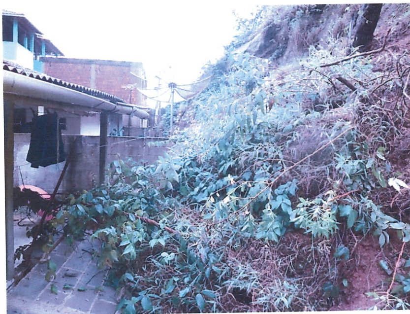
Casa interditada - Queda de talude sobre casa
