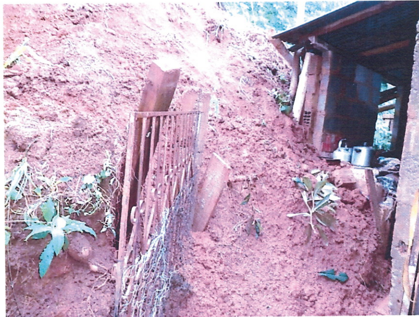
Casa interditada - Queda de talude sobre casa
