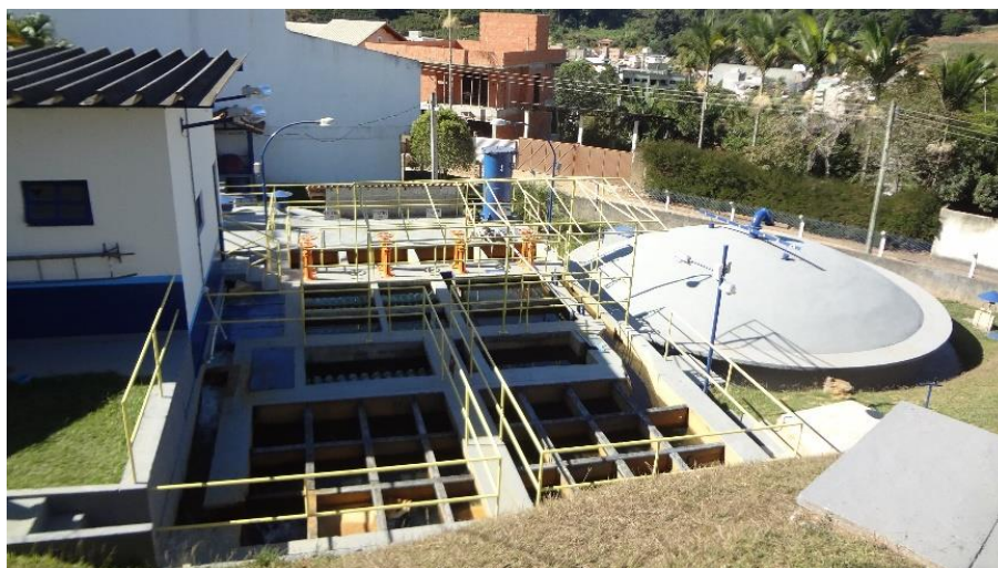
Figura 3-23 - Estação de Tratamento de Água de Venda Nova do Imigrante.
